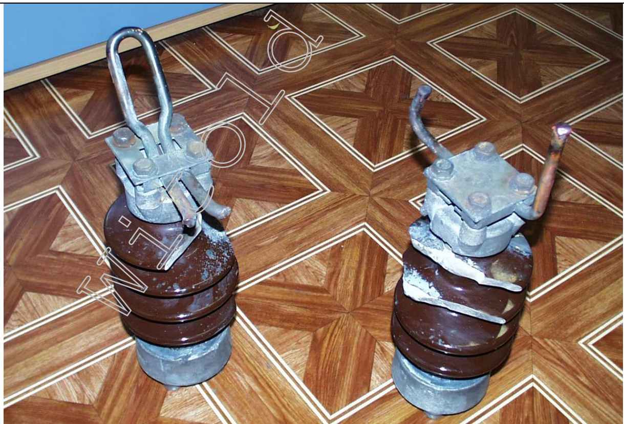
Fot.1 i 2: Fragmenty uszkodzonego odłącznika
